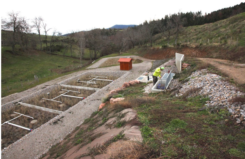
Décembre 2023. Après un début difficile à cause de la canicule d'août, les roseaux se sont bien implantés dans les deux lits d'épuration. Les eaux usées sont réparties en alternance entre les trois casiers du lit supérieur et les deux casiers du lit inférieur.
